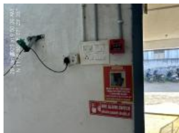
36. Fire alarm call point.JPG
